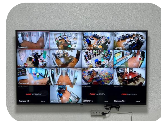
GS語学院 建物別 CCTVモニタリング
